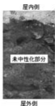
写真1 コンクリートコアの中性化状況
